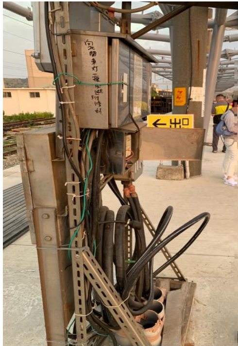
圖四十八 追分車站月台施工電器並無三角錐設施，如觸電恐有生命危險
