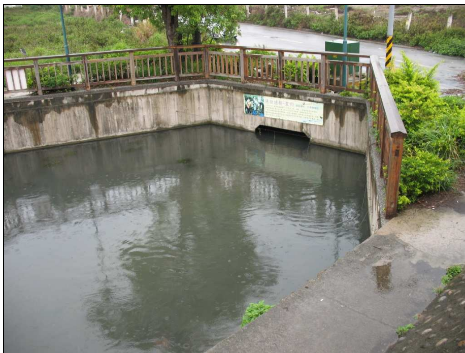
圖 4 此為黎明溝上游暗渠與明渠交接處，可見水表面與頂部近乎相接
