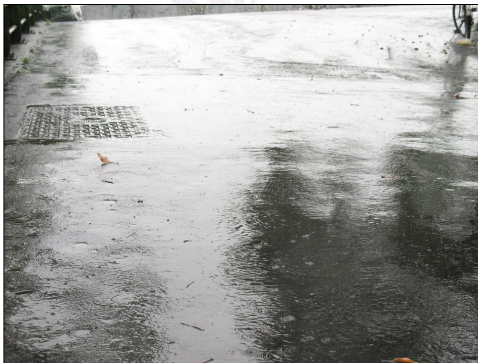
圖 25 現場下雨時的路面情形
