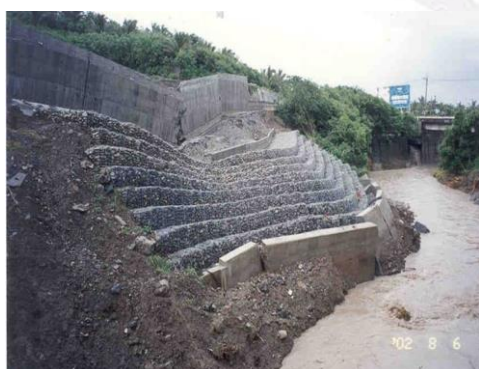
圖 21 護岸破壞：基礎承载力不足
