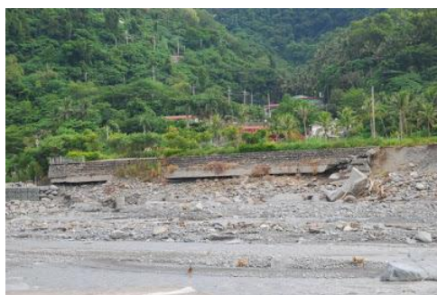
圖 19 護岸破壞：基礎淘刷
