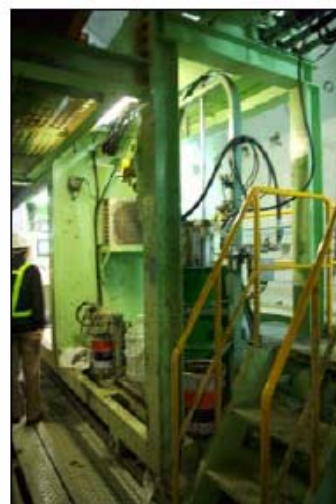
操作室與油壓室
