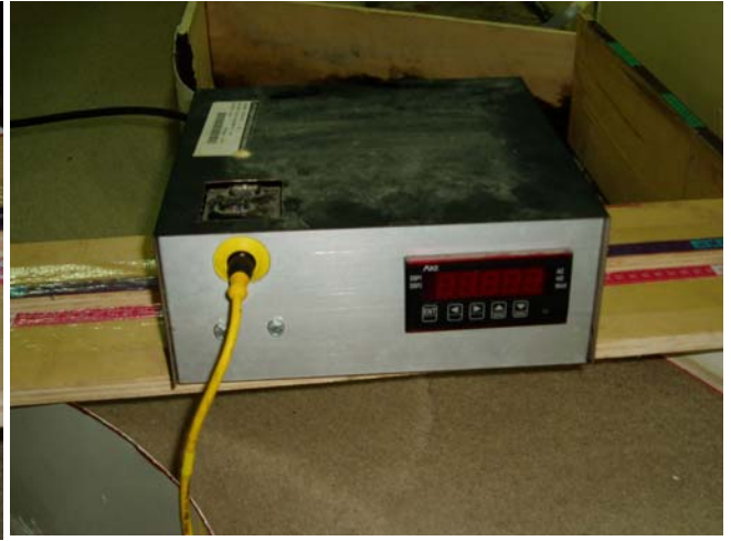
照片 3-3 超音波水位計數據轉換顯示器
